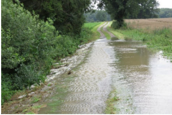
Überschwemmung eines FI-Weges zwischen Bevenrode und Waggum. Rohrdurchlass-Querschnitt zu klein.
