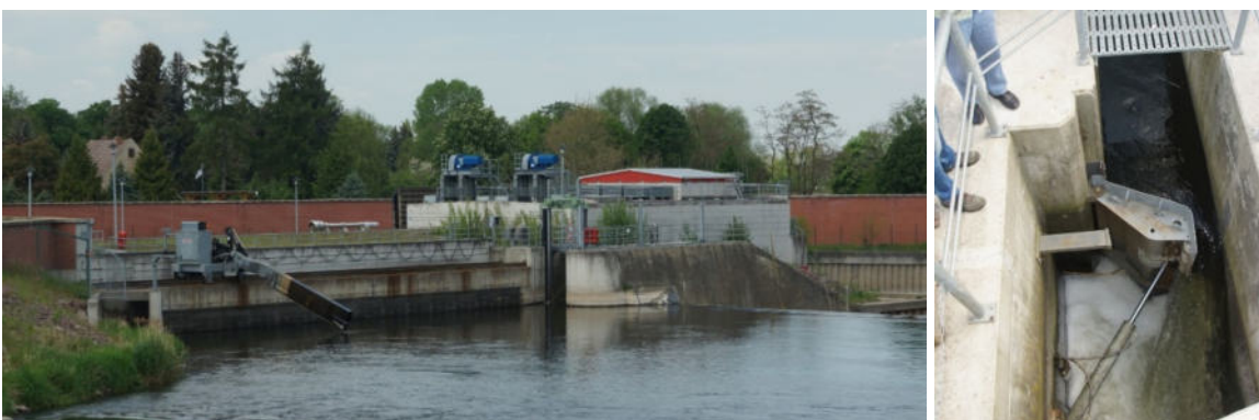
Der Rechenreiniger in Raguhn/Mulde nimmt die Arbeit auf (links) und Bypass mit Spülklappe für grobes Schwemmgut (rechts) (Foto Stefan Ludwig - 2017)
